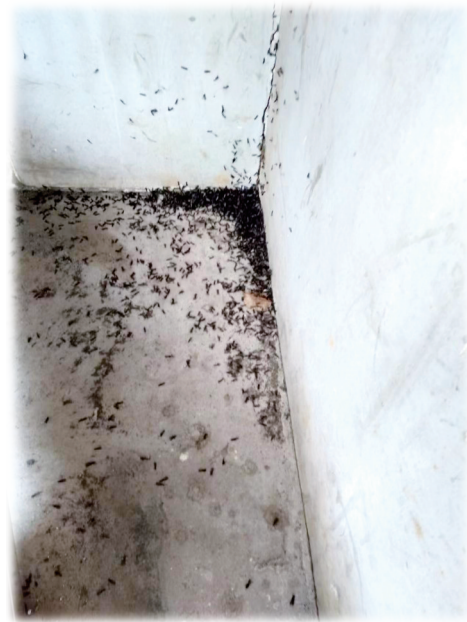
一小区楼栋口,大堆白蚁聚集在墙角。
