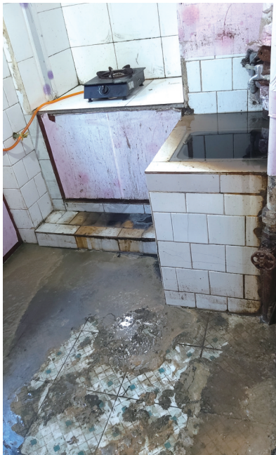
袁先生家的厨房地面全是污水。
