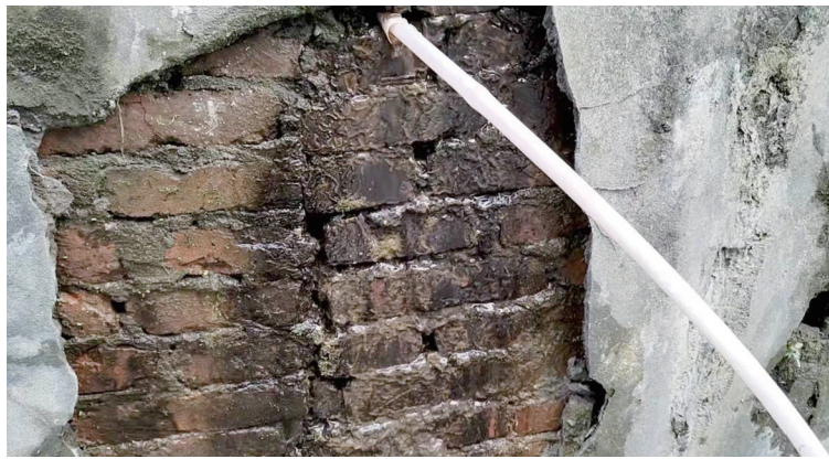
小区内,靠近山体的一面墙上污水横流。
