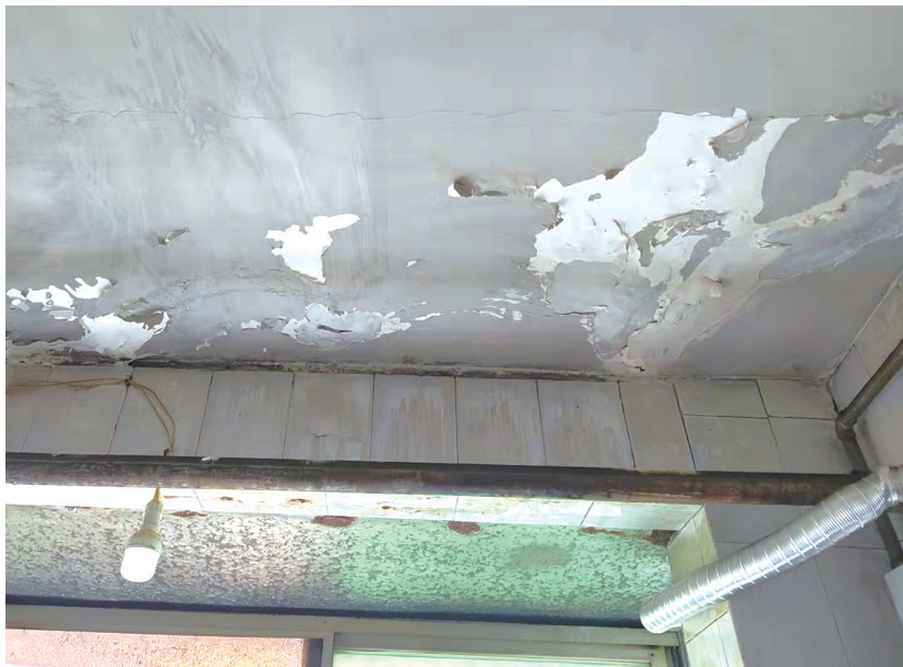
勾大爷家厨房天花板部分墙皮脱落。
