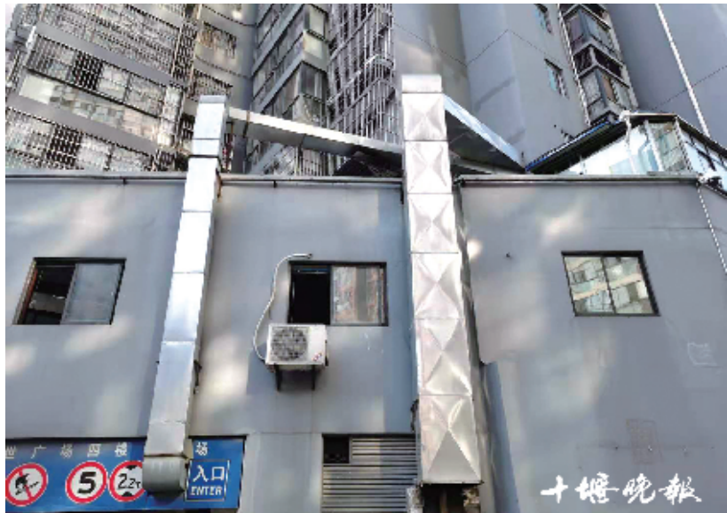
烧烤店排烟管道连接到居民楼共建风道。
