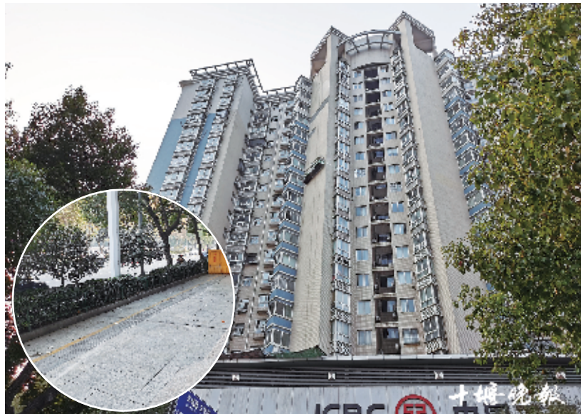
青年大厦墙面老化,导致外墙砖脱落。
