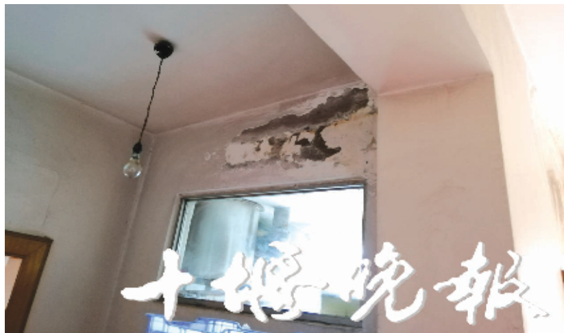
楼上卫生间漏水,导致楼下贺女士家墙面已发霉。
