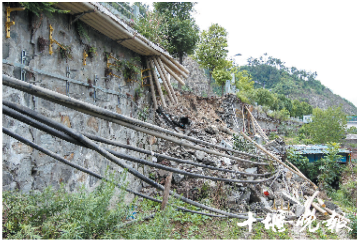
高挡墙坍塌现场。
