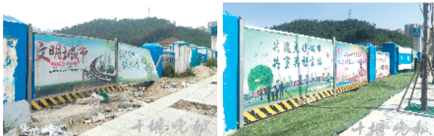
破损的围挡和随处可见的建筑垃圾(回访前后)。
