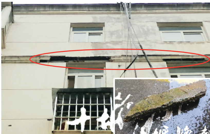
4号楼6楼和7楼之间的墙裙多次脱落。
