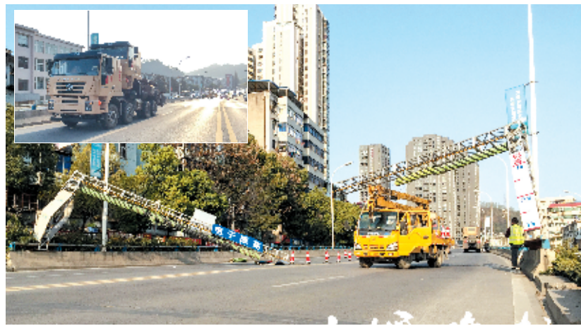
事故现场,工作人员正在拆卸损坏的限高架,不远处停着肇事车。
