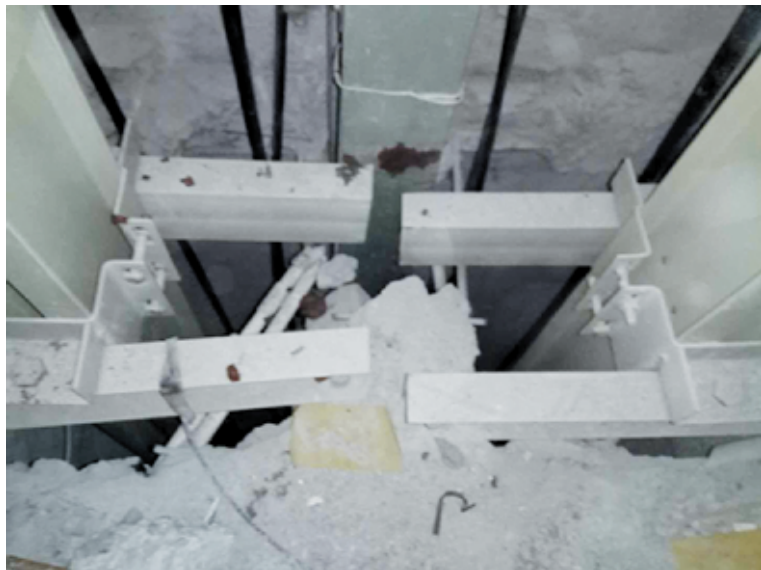
电缆井治理前。
