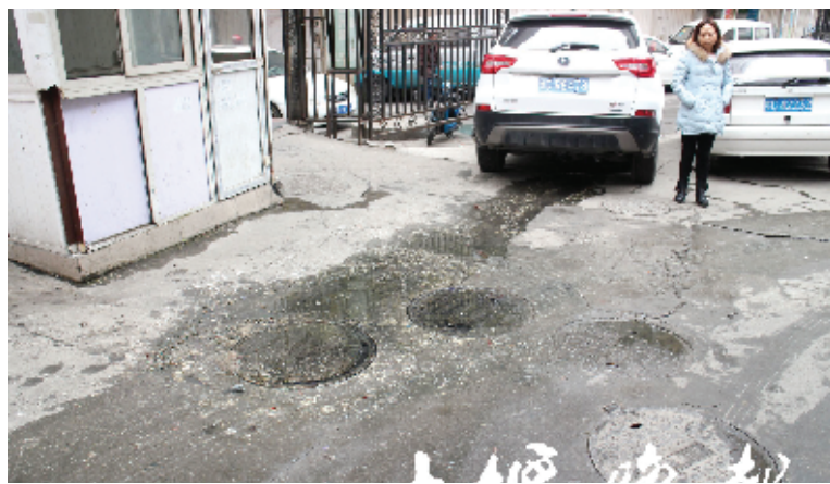
王朝花园小区主干道上的两个污水井正往外冒粪水。
