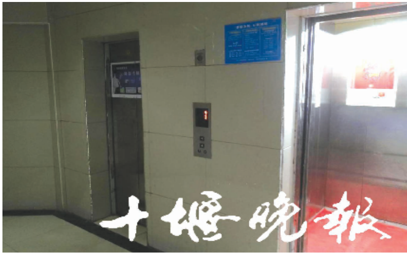
小区11号楼的两台电梯,其中一台已经停用。
