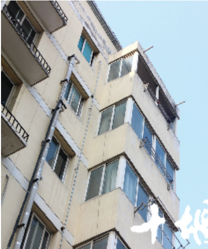
顶楼7层一住户阳台玻璃缺失。
